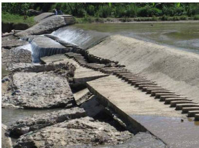
La Tannerie : Échec des travaux de réhabilitation de la prise. La réhabilitation des périmètres doit se faire de manière planifiée, globale, intégrée et sur la base d'études techniques et socio-économiques de qualité.
